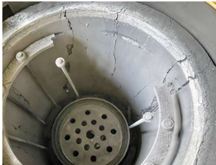
写真 2. 炉内破損状況
